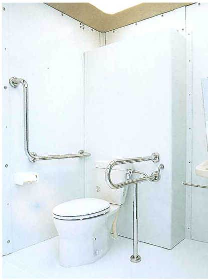
簡易水洗式洋式便器
